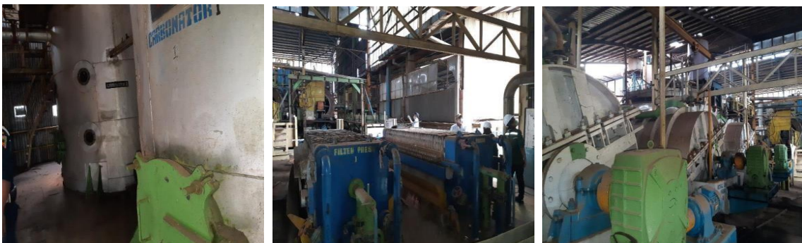
Gambar 2.14. Kondisi Stasiun Defekasi
