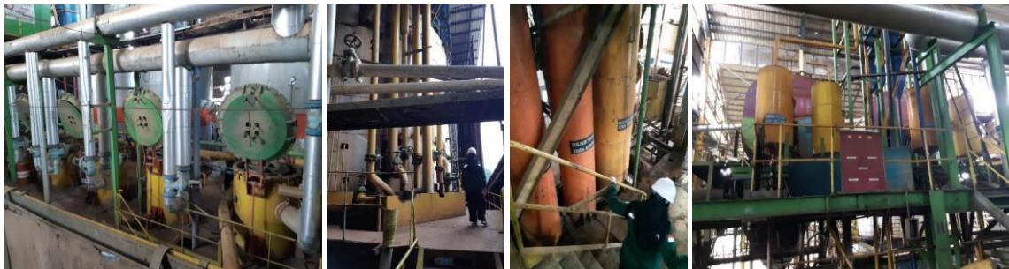
Gambar 2.11. Kondisi Stasiun Pemurnian
