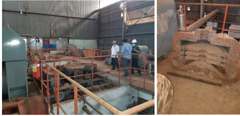
Gambar 2.7. Kondisi Stasiun Pembangkitan (Turbin)
