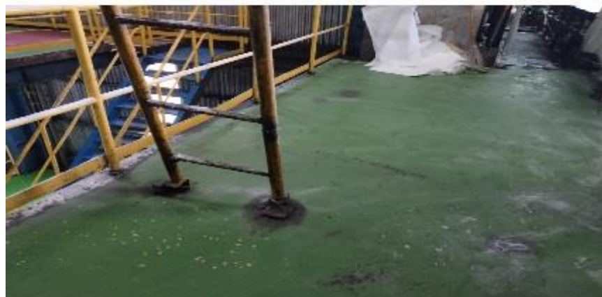
Gambar 5. Sesudah Penggunaan Wet Scrubber
